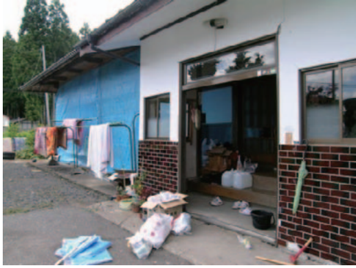
(a) 外壁損傷及びサッシの脱落
