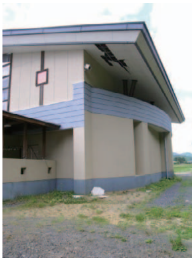
(a) 軒天外装材落下
