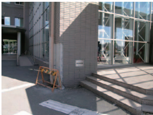
(a) 外装タイルの剥落
