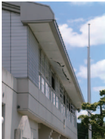
(a) 被害状況
