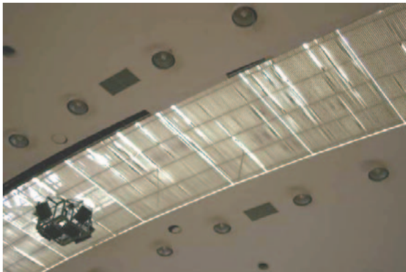
図-8.4.16 トップライト近傍での天井損傷状況
