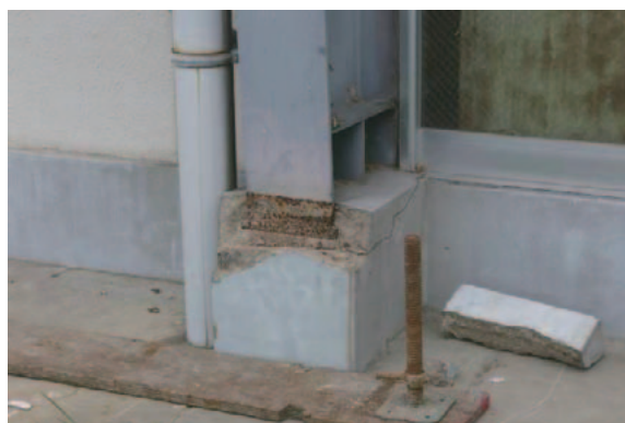
図-8.4.6 鉄骨柱脚部かぶりコンクリート剥落
