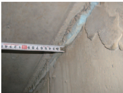
図-8.5.3 シール材のずれ
