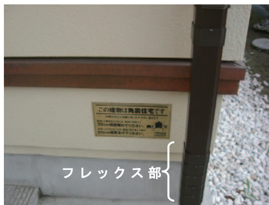
(b) 免震表示及び雨どいのフレックス部分
