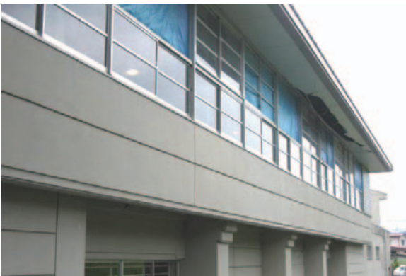
図-8.4.13 損傷した軒天井
