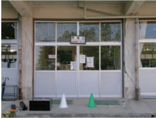
(c) 1階出入口脇の柱の損傷
