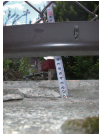
(b) 水路際の地盤の沈下
