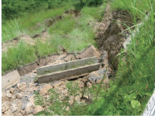
図-8.2.3 B小学校校庭南側の法面崩壊
