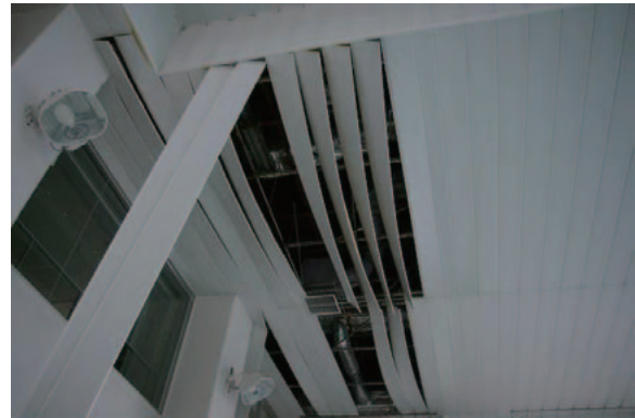
図-8.4.21 落ちかけている天井パネル
