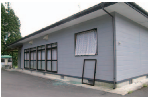
(a) 建築物F（窓サッシ脱落）
