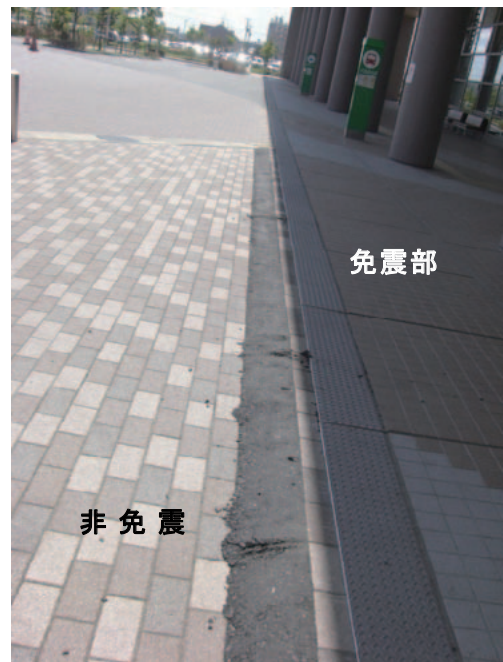
(b) 舗装の損傷（補修済み）
