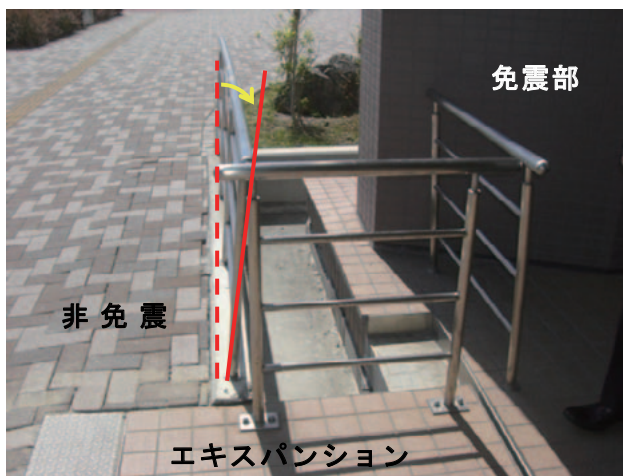
(a) 金属柵の傾斜
