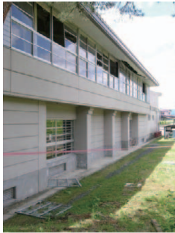
(a) 被害状況
