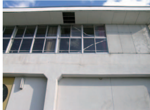
(b) 軒天落下及びブレース座屈
