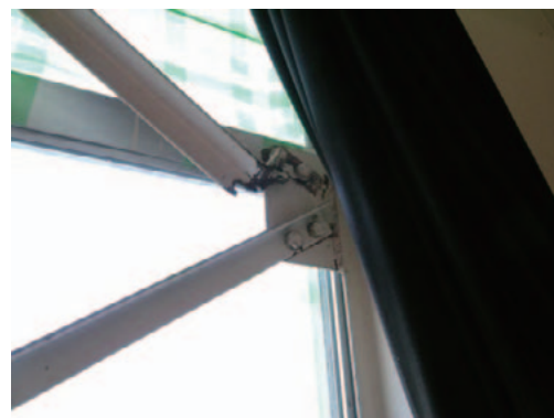
(d) ブレース端部接合部の破壊
