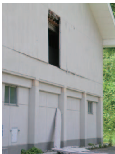
(a) 西側妻面の外装ALCパネルの落下
