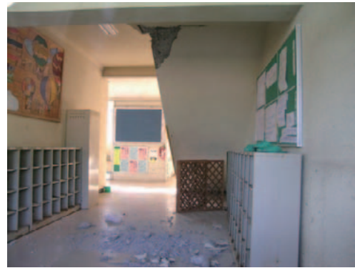
(d) 1階階段上部の損傷
