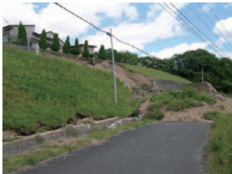
(a) 南側斜面擁壁の崩壊
