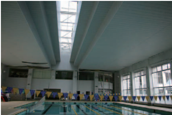
図-8.4.20 屋内プールの被害状況
