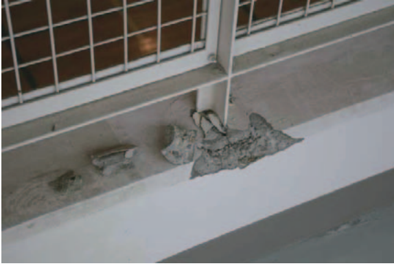
図-8.4.11 ギャラリー手すりの脚部の損傷
