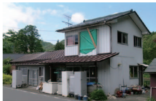
(b) 住宅の窓の損傷
