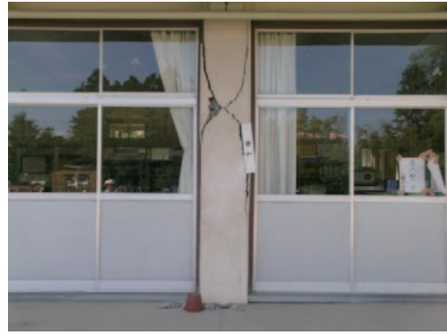
(b) 1階柱のせん断破壊
