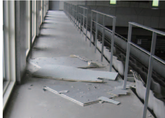
図-8.4.17 脱落した天井版
