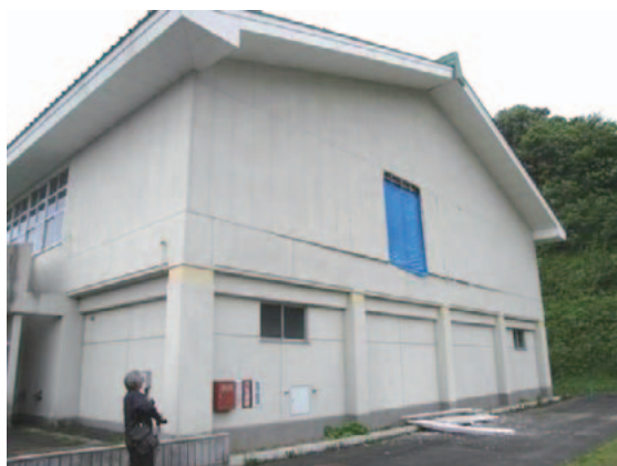
図-8.4.7 ALCパネル脱落状況
