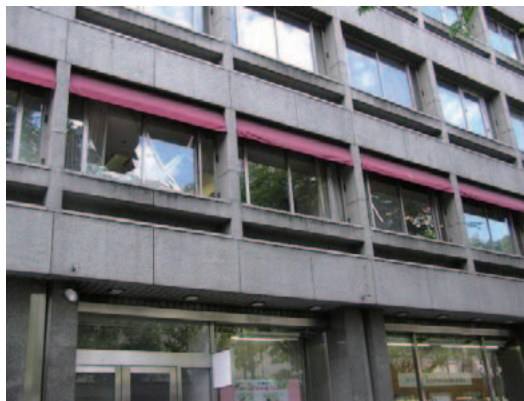
図-8.4.2 2階窓の被害（仙台市提供）
