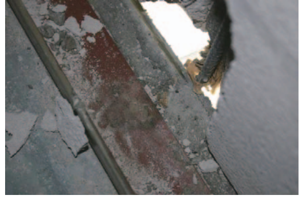
図-8.4.10 ALCパネル下端部の溶接跡
