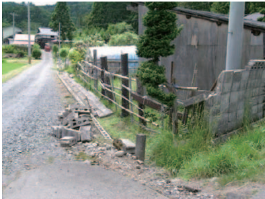
(a) ブロック塀の倒壊
