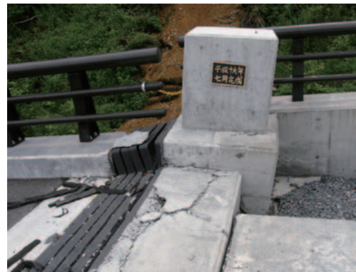
写真-6.46 A2橋台上部の損傷
