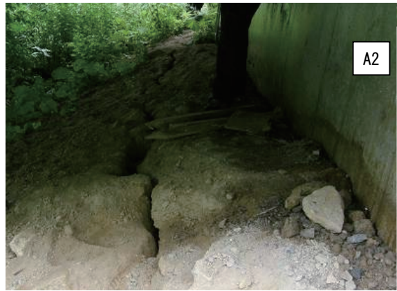
写真-6.31 A2橋台前面の地割れ
