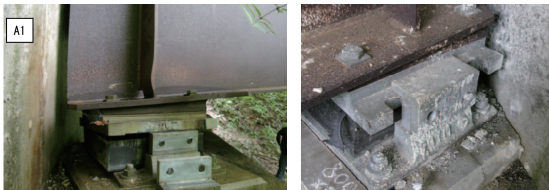
写真-6.40 A1 橋台支承部の損傷
