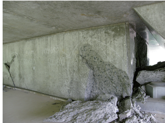
写真-6.29 P4 落橋防止構造の損傷
