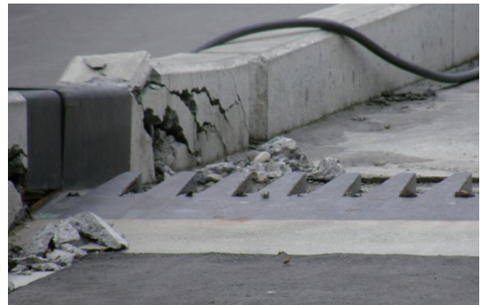
写真-6.26 伸縮装置の損傷
