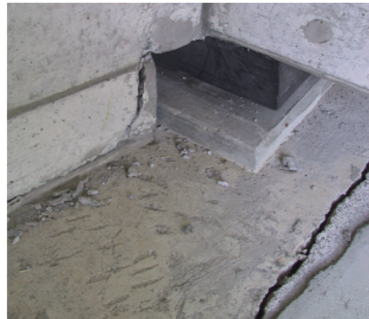
写真-6.50 かぶりコンクリートの剥離
