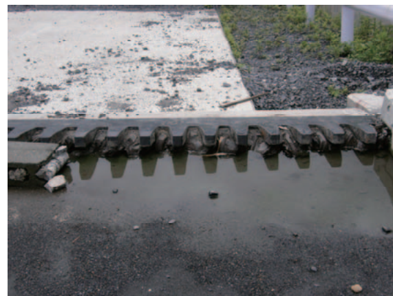
写真-6.44 伸縮装置部の段差
