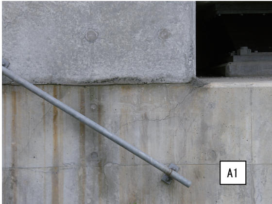
写真-6.28 A1 橋台翼壁のひび割れ
