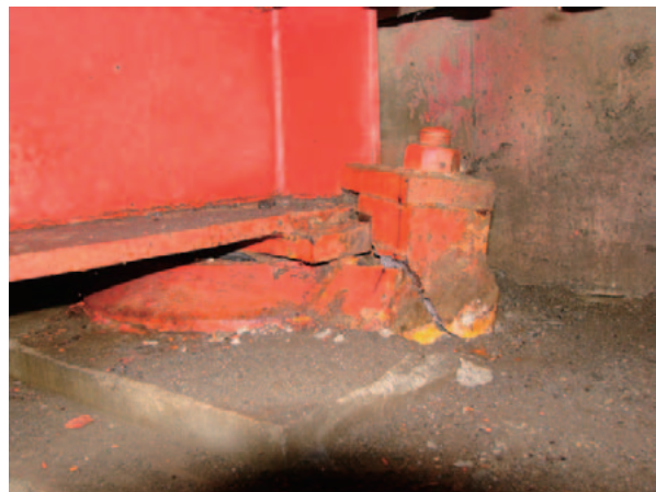
写真-6.3 固定支承の損傷
