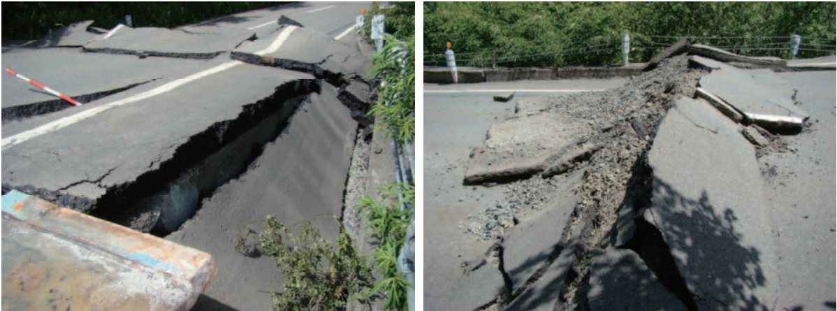
写真-6.23 A2 橋台の後方路面の変状
