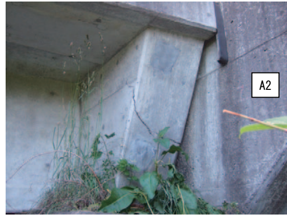
写真-6.39 PC横桁のひび割れ
