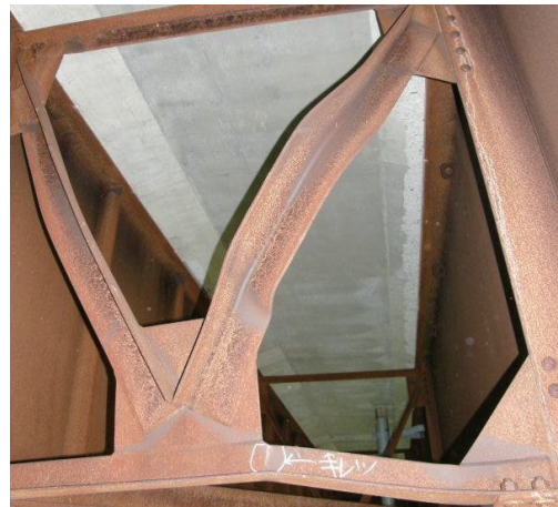
写真-6.33 横構・対傾構の座屈
