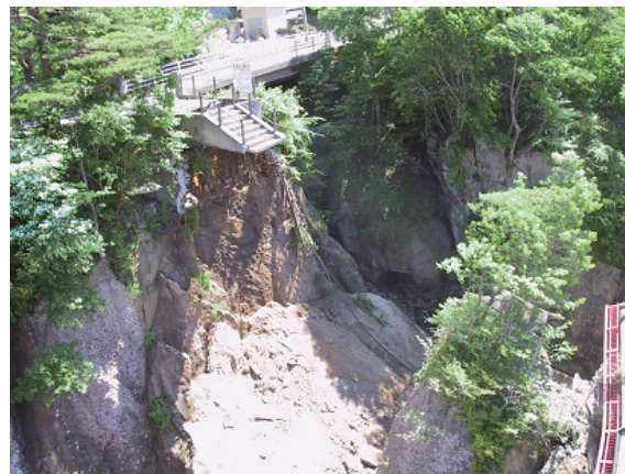
写真-6.6 旧道にかかる歩道橋の落橋
