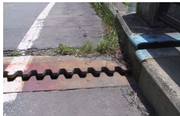
写真-6.9 伸縮装置のずれ
