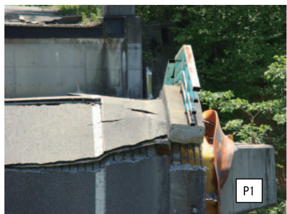
写真-6.18 P1 橋脚上で屈曲している主桁
