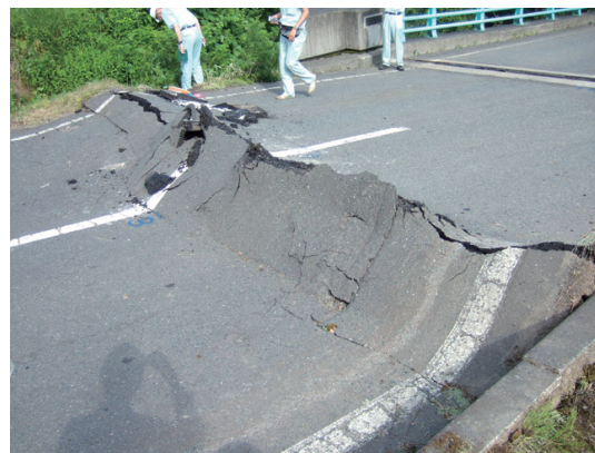
写真-6.37 A2 橋台背面付近の路面の割れ
