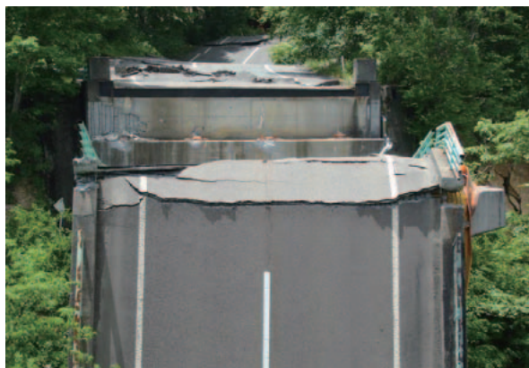
写真-6.14 落橋した祭時大橋
