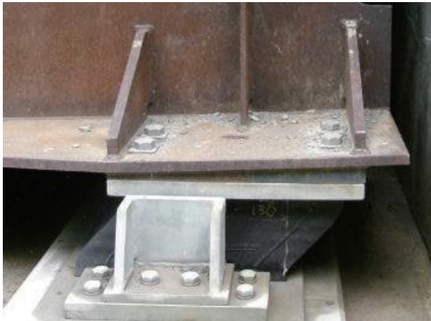
写真-6.32 A1橋台ゴム支承の変形
