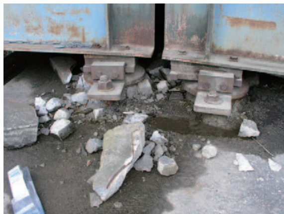
写真-6.10 橋脚上の支承沓座モルタルの損傷
