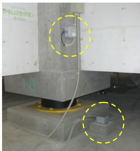
図-5.4.2 免震層内の強震計設置状況
