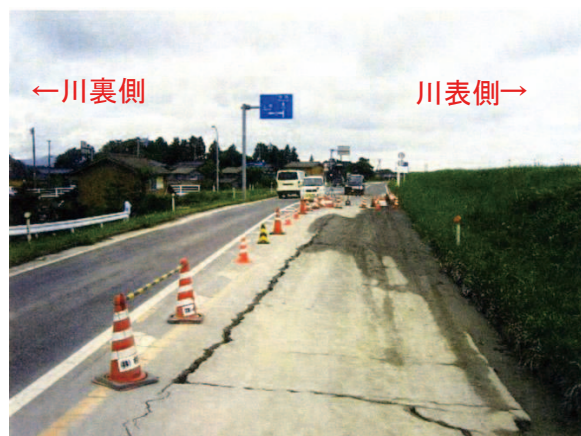
写真-5.1 信濃川本川 0kp 付近左岸堤防の裏小段に生じた縦断亀裂（北陸地方整備局撮影）
