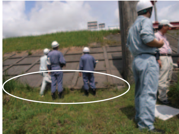
写真-5.3 町軽井揚水機取水樋管周辺の護岸（○印の箇所には沈下および空洞が発生）
