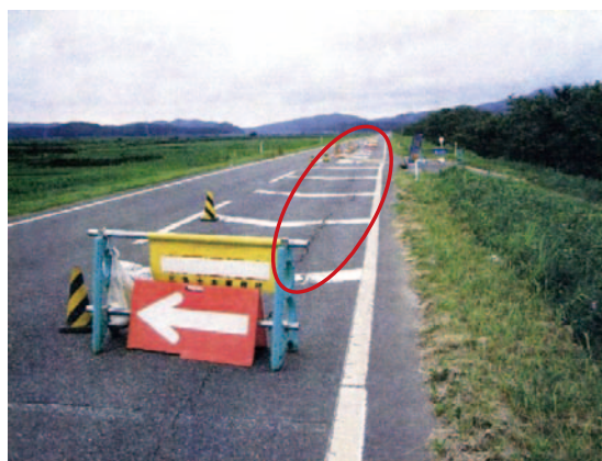
写真-5.4 大河津分水路 2kp 付近右岸における堤防天端の縦断亀裂（上流側から下流側を望む）（北陸地方整備局撮影）
