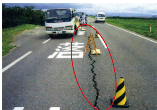
写真-5.5 大河津分水路 2kp 付近右岸における堤防天端の縦断亀裂（下流側から上流側を望む）（北陸地方整備局撮影）
