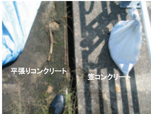
写真-5.7 矢板背後に生じた開き
