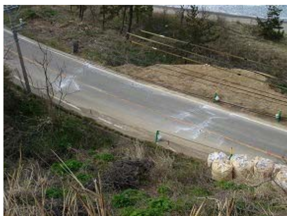
4-c 路面の亀裂の状況
