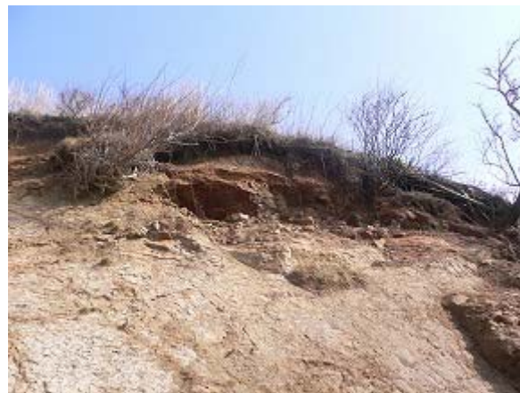
6-c 岩盤崩落箇所
