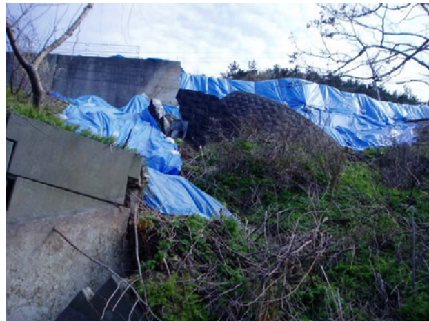
写真-7.2.44 テールアルメ壁に隣接する地山崩壊
