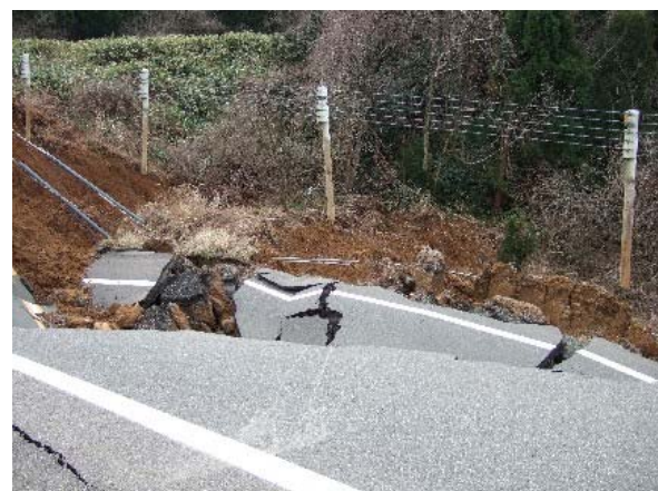
(b) 崩土の状況
