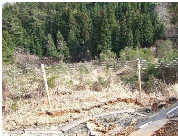
(b) 崩土の状況
