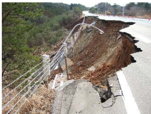
(a) 盛土崩壊状況
