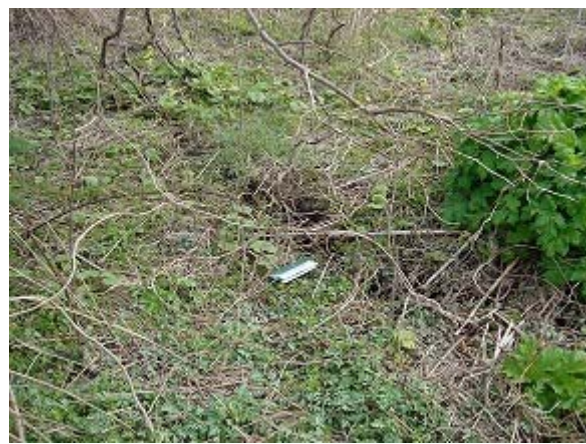
5-b 背後斜面の開口亀裂
