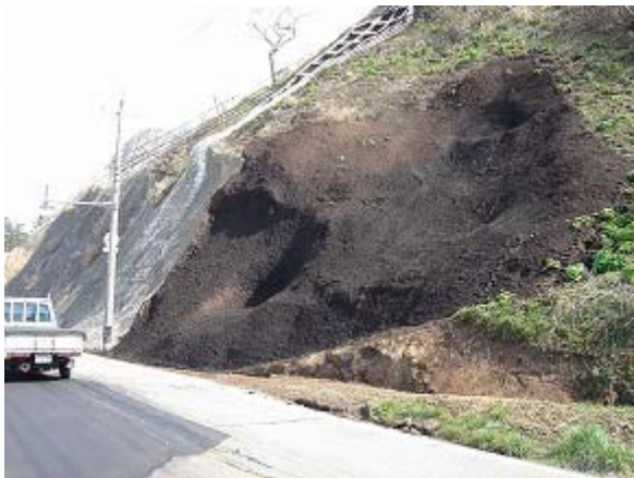
3-a 崩壊箇所の全景
