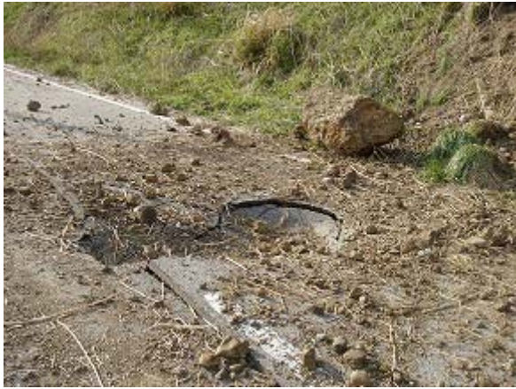
20-c 落石による路面の陥没
