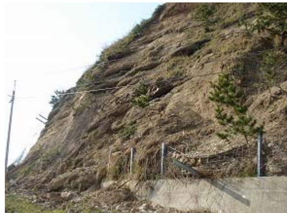
21-b 対策工の被災状況
