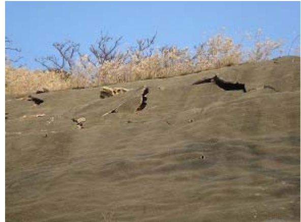
14-d 吹付けモルタルの座屈
