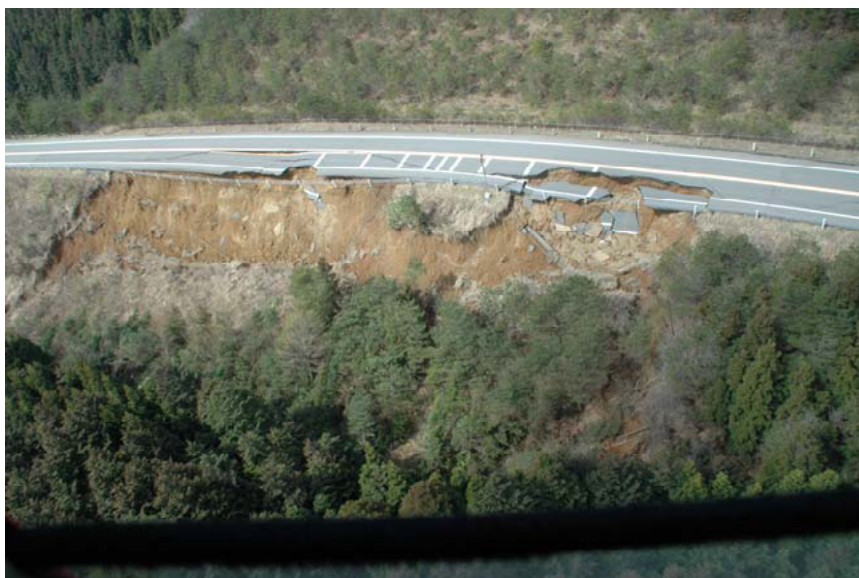
写真-7.2.16 被災箇所の航空写真（能登有料 七尾市中島町小牧その1 2 15.9kp 縦-26）（石川県提供） 1)
