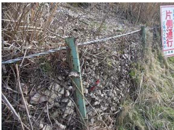
11-c 防護柵での崩土の受け止め
