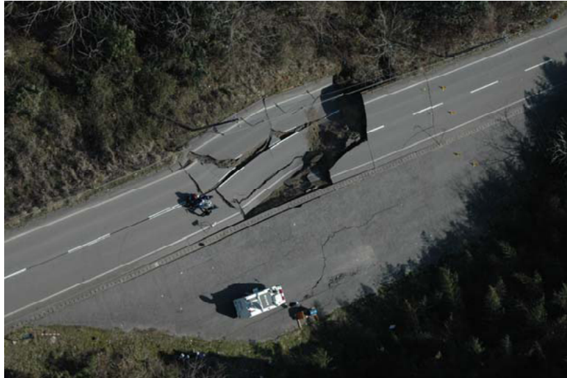
写真-7.2.35 被災箇所の航空写真（国道 249 号志賀町深谷）（石川県提供） 3)
