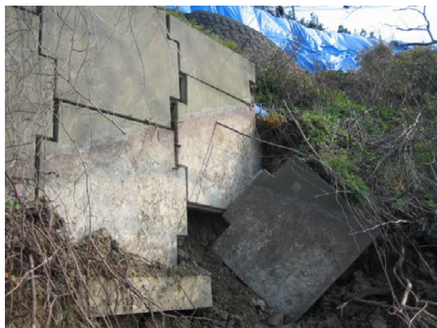
写真-7.2.43 国道 249 号テールアルメ壁の被害
