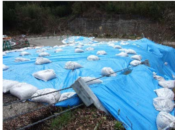
(b) 盛土崩壊状況
