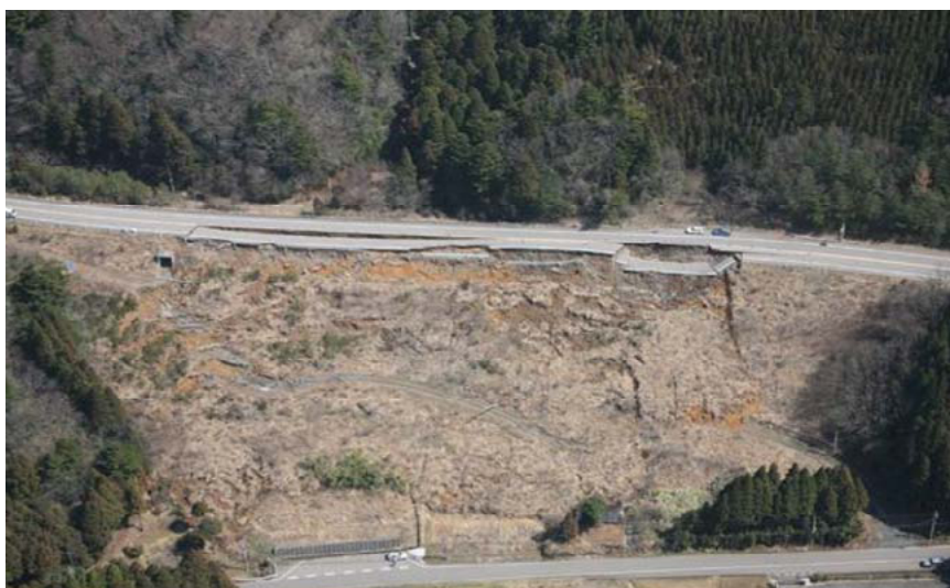
写真-7.2.4 被災箇所の航空写真 (能登有料 七尾市中島町土川 6.3kp 縦-9) (石川県提供) 1)
