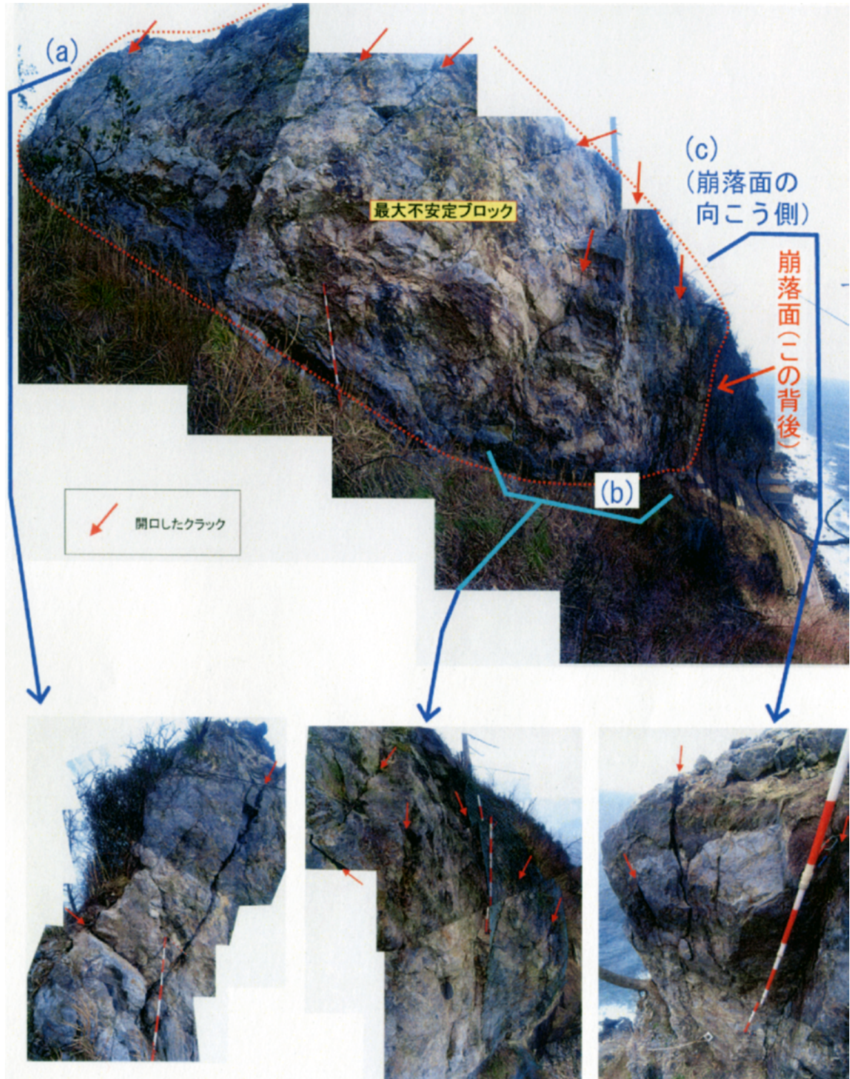
写真-7.3.26 背後の岩盤斜面の亀裂の状況（復旧検討会資料 5) より）
