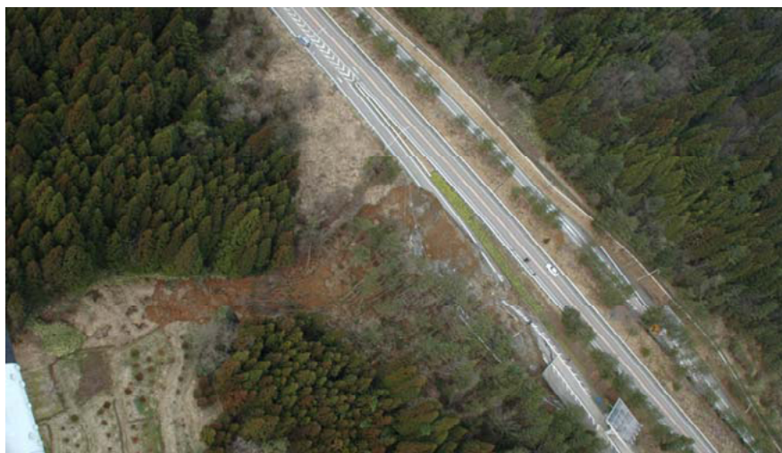
写真-7.2.7 被災箇所の航空写真（能登有料 七尾市中島町横田その1 10.6kp 上りオンランプ 縦-10）（石川県提供） 1)
