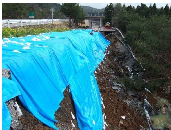
(a) 盛土崩壊状況
