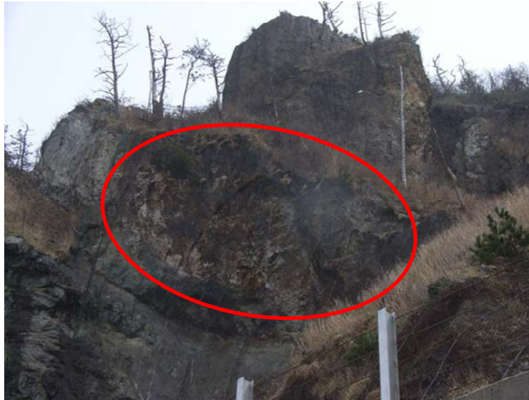
写真-7. 3. 24 崩落面の拡大写真（楢円内）
