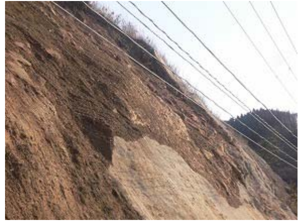
13-d 崩壊面と吹付け工の状況
