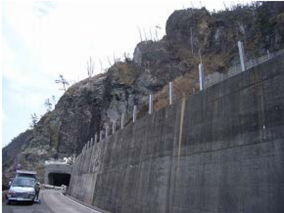
2-a 被災箇所の全景
