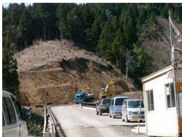
写真-7.3.18 門前町和田地区（斜面全景）
