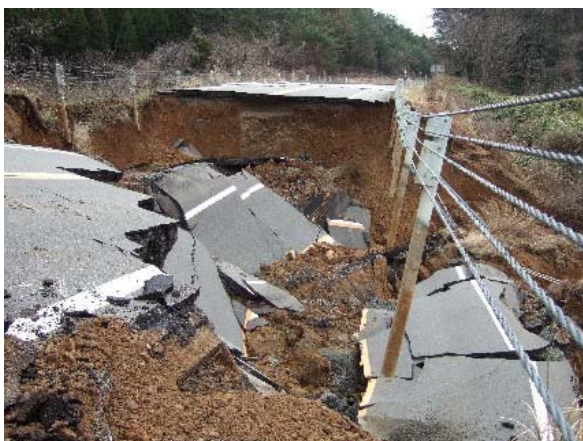
(a) 盛土崩壊状況
