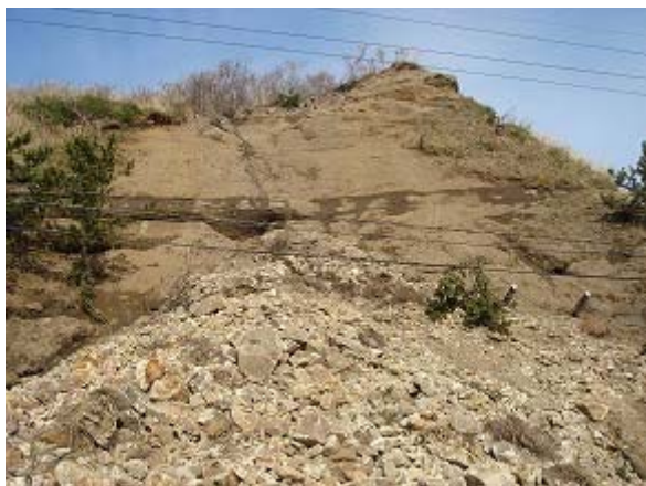
22-a 崩壊面と土砂
