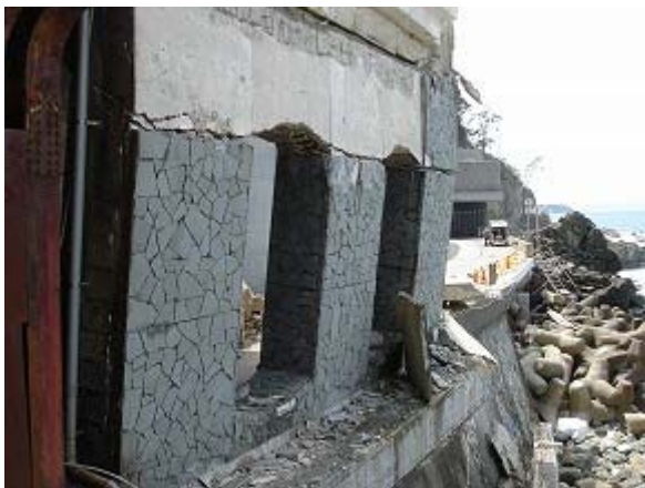
2-c 破壊された支柱
