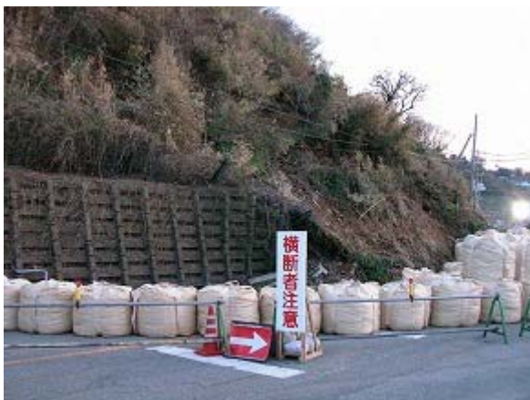
15-a 井桁組擁壁の崩壊
