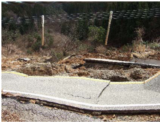
(c) 崩土の状況
