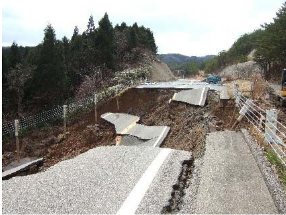
(a) 盛土崩壊状況
