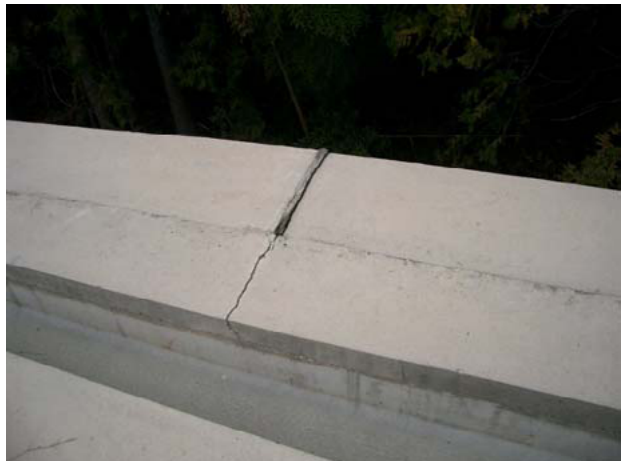
写真-7.2.48 天端笠コンのクラック
