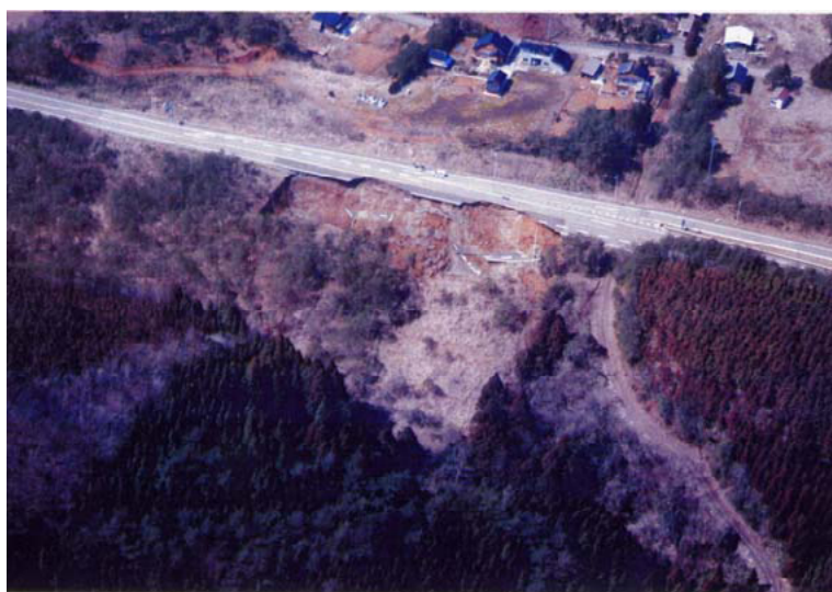
写真-7.2.29 被災箇所の航空写真（能登有料 穴水町越の原その4 23.4kp 縦-41）（石川県提供） 1)
