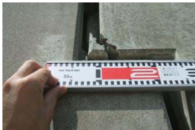
写真-7.2.45 テールアルメ壁面工の端部破損
