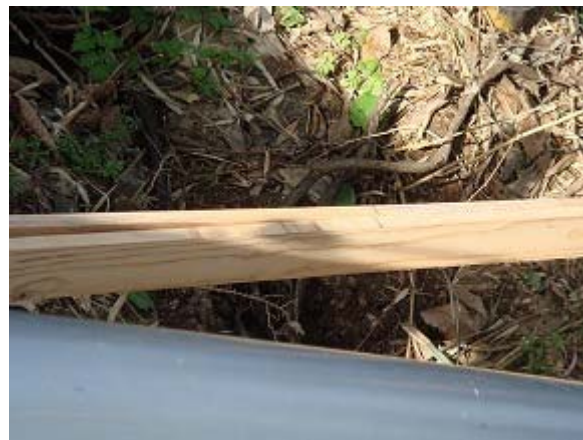
15-e 伸縮状況（圧縮変形）
