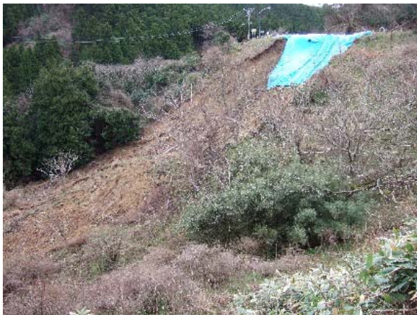
(a) 盛土崩壊箇所全景
