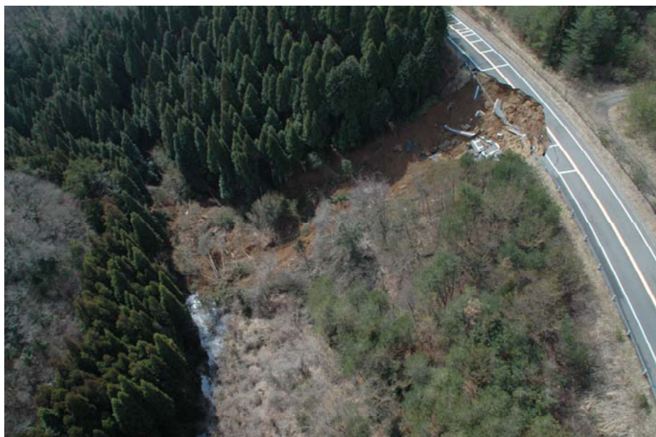
写真-7.2.13 被災箇所の航空写真（能登有料 七尾市中島町小牧その7 14.7kp 縦-21）（石川県提供） 1)
