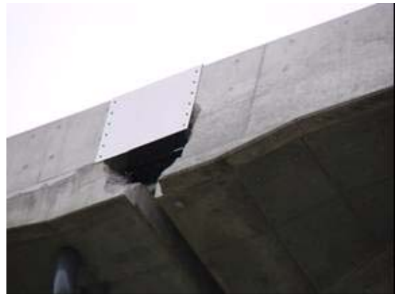
写真-6.28 左写真○の拡大写真
