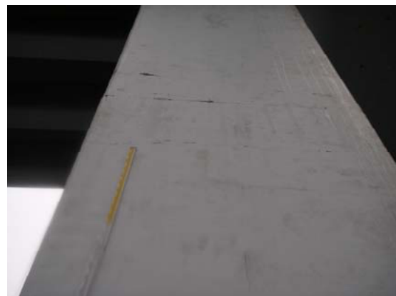
写真-6.11 P10橋脚側面のひび割れ (石川県撮影)
