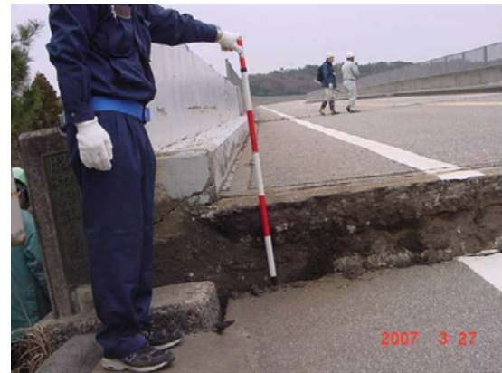
写真-6.20 橋台背面の段差
