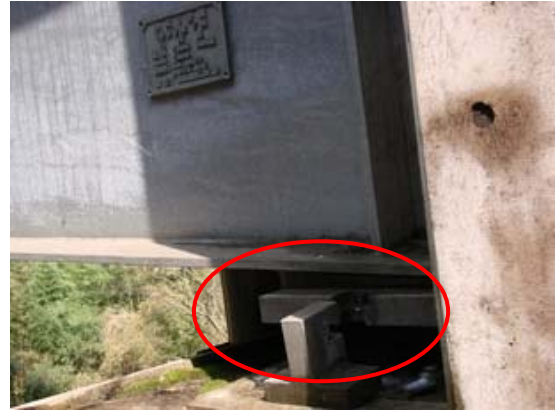
写真-6.32 支承部サイドブロックの 変形
