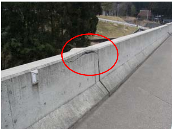
写真-6.38 橋台と端部桁壁高欄の衝突
