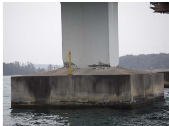
写真-6.5 P7 橋脚損傷状況（石川県撮影）
