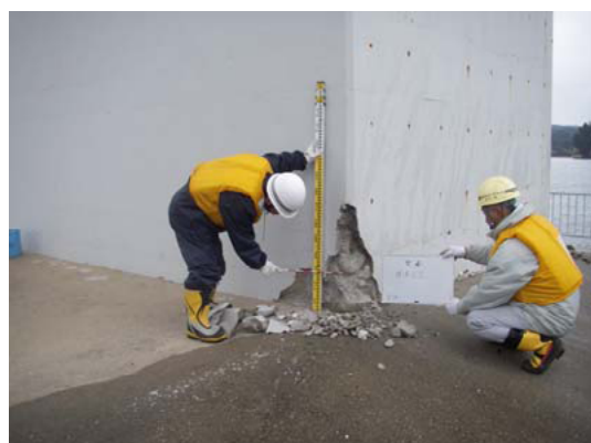
写真-6.12 P11橋脚のコンクリート剥 落箇所（石川県撮影）
