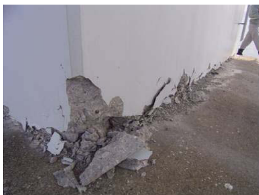
写真-6.3 P6橋脚基部の損傷状況 （写真-6.2の○部拡大）
