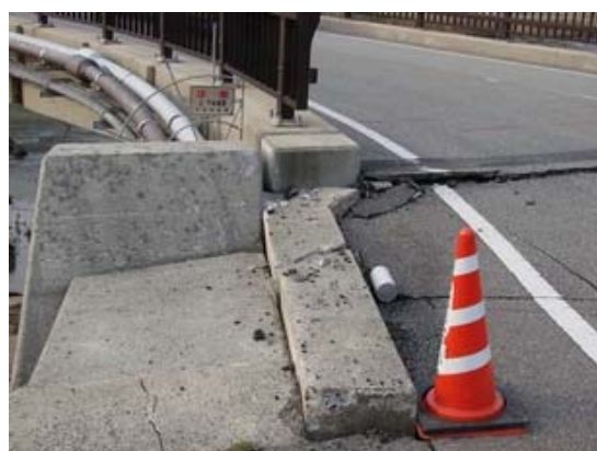
写真-6.42 鹿磯橋(橋台部の損傷)
