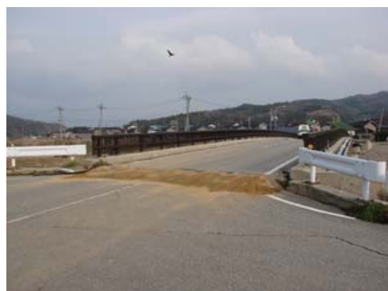
写真-6.41 鹿磯橋全景(橋台背面沈下)
