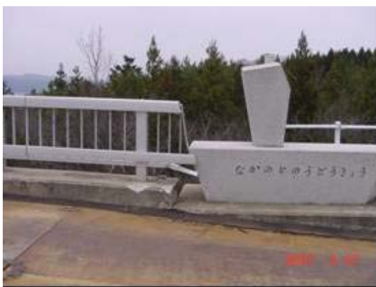
写真-6.16 高欄の損傷
