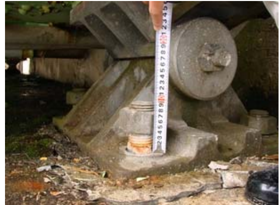
写真-6. 30 支承部アンカーボルト抜 出状況
