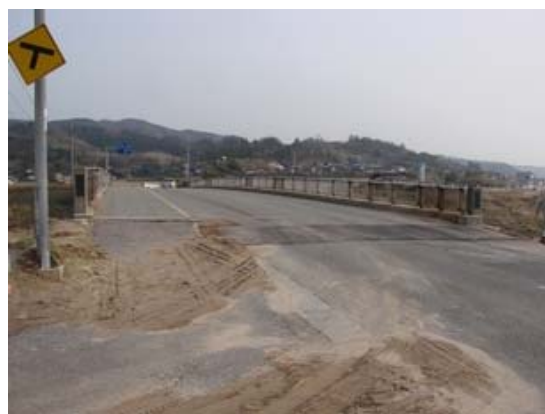
写真-6.40 西の端橋全景(橋台背面沈下)
