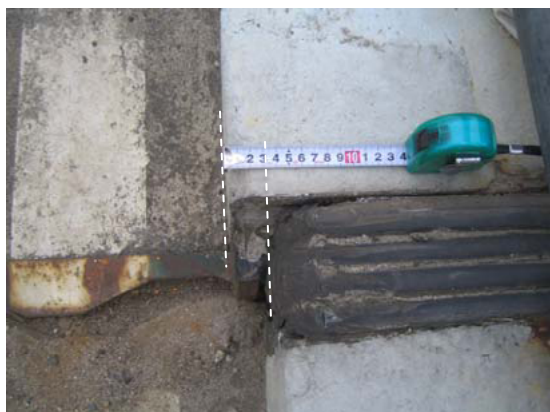
写真-6.14 地覆の橋軸直角方向変位
