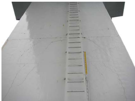
写真-6.10 P10橋脚のせん断ひびわれ (石川県撮影)
