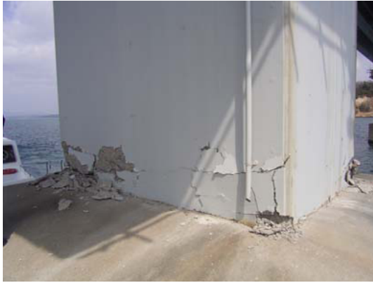
写真-6.6 P7橋脚基部の損傷状況
