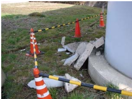
写真-6.35 写真-6.34の横梁部から落下したかぶりコンクリート
