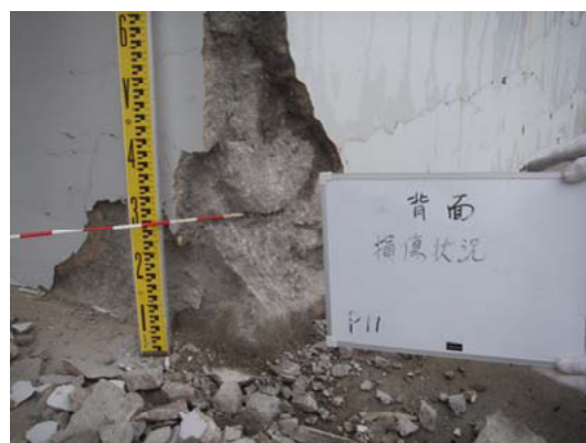
写真-6.13 P11橋脚のコンクリート剥 落箇所（石川県撮影）
