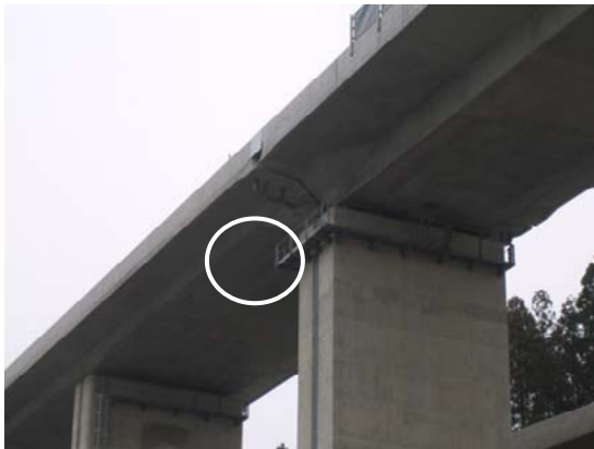
写真-6.27 此木高架橋損傷箇所
