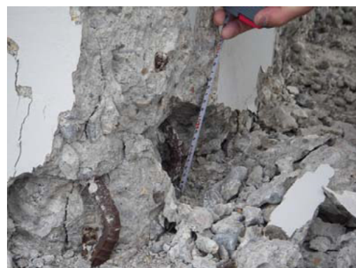
写真-6.4 橋脚基部の軸方向鉄筋のはらみだし状況
