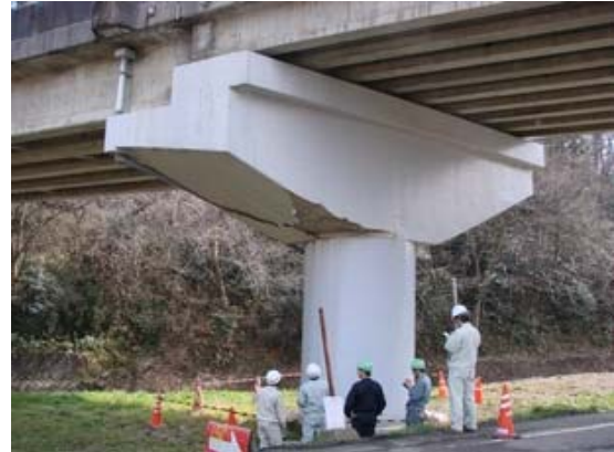
写真-6.34 橋脚のかぶりコンクリートの剥落
