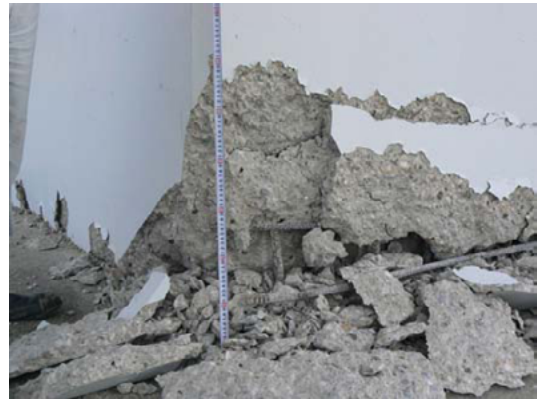
写真-6.7 P7橋脚基部の損傷状況
