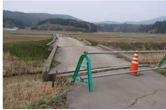
写真-6.44 (13) 橋(桁の回転による変位)
