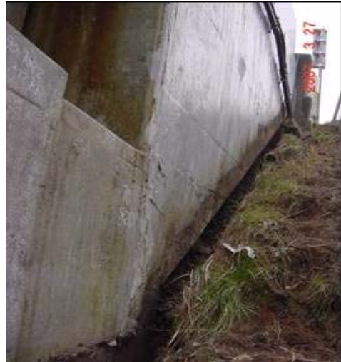
写真-6.23 橋台背面にできた空洞
