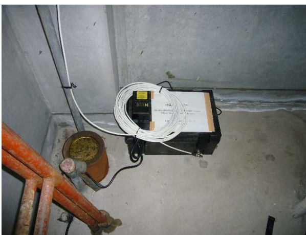
写真-3.3 輪島市役所 1階強震計設置状況
