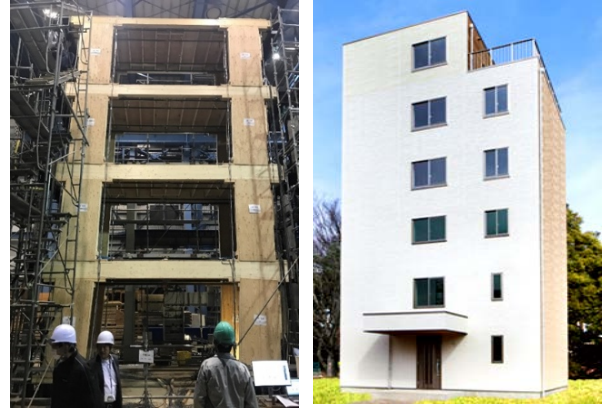
写真 2 枠組壁工法実大 4 階 写真 3 枠組壁工法 6 階建て 建て静的加力試験 実大実験棟
