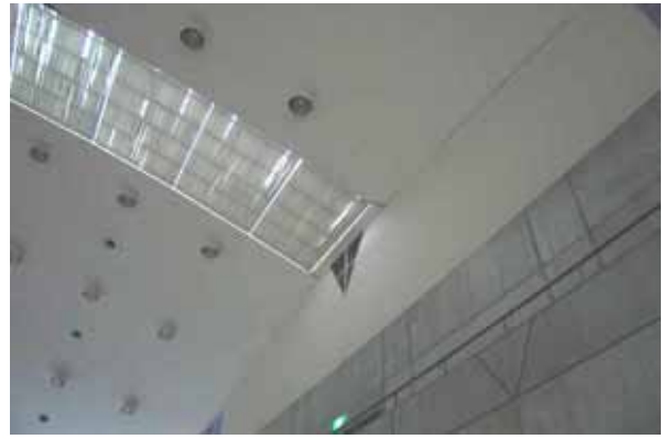
写真-4.24 妻面との取り合う天井損傷状況
