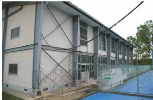
写真-4.6 ブレースが座屈した東側桁行構面
