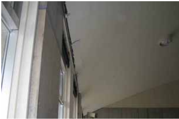
写真-4.27 桁行方向の取り合いでの天井損傷状況
