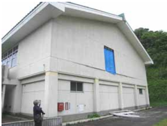
写真-4.9 建物CのALCパネル脱落状況
