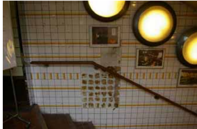
写真-4.4 地下1階への階段で剥落したタイル
