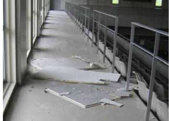
写真-4.26 脱落した天井板
