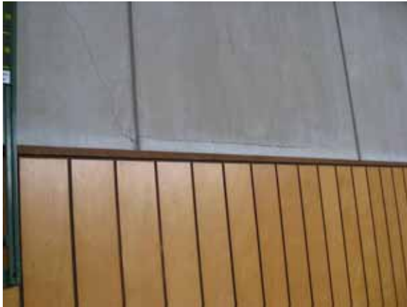
写真-4.13 アリーナ RC 壁の軽微なひび割れ
