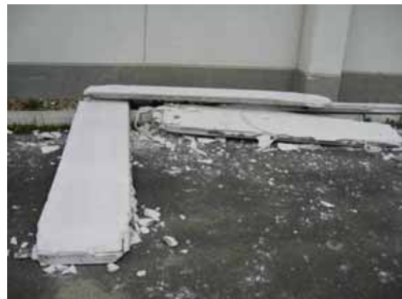
写真-4.10 脱落したALCパネル
