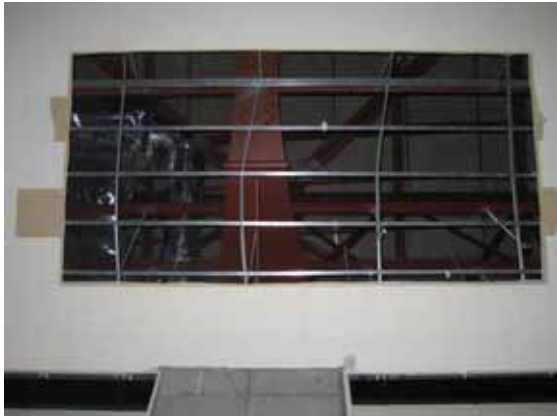
写真-4.25 天井板脱落箇所と下地材損傷状況
