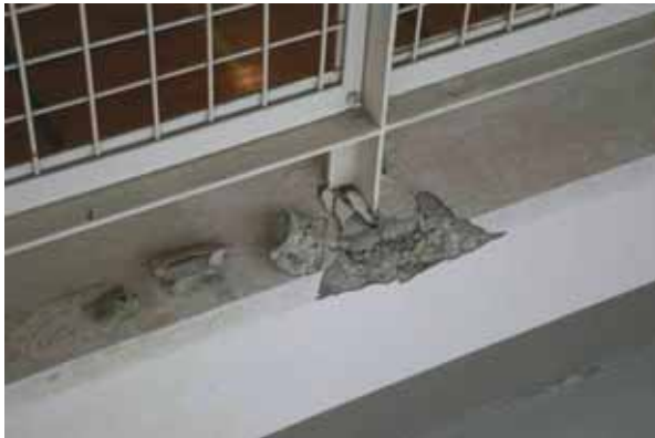
写真-4.17 ギャラリー手すりの脚部の損傷
