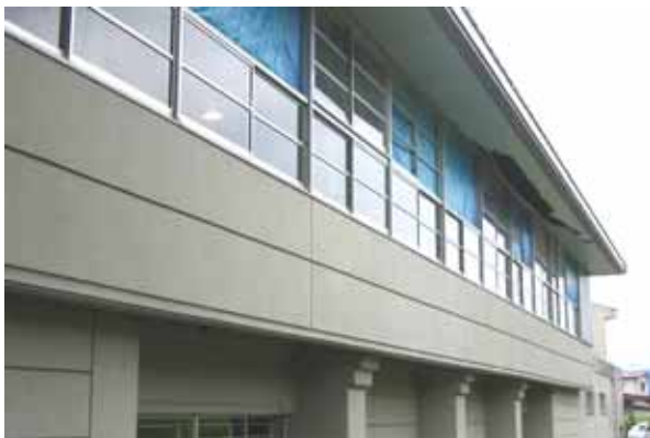
写真-4.19 桁行方向の中程で損傷した軒天井
