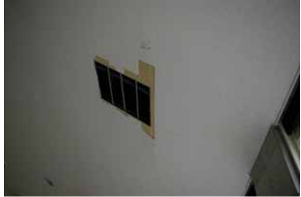
写真-4.28 天井板脱落箇所
