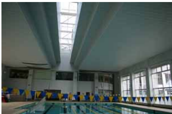
写真-4.29 屋内プールの被害状況
