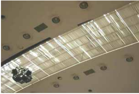
写真-4.23 トップライト近傍での天井損傷状況
