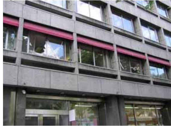
写真-4.2 2階窓ガラスの被害状況（仙台市提供）
