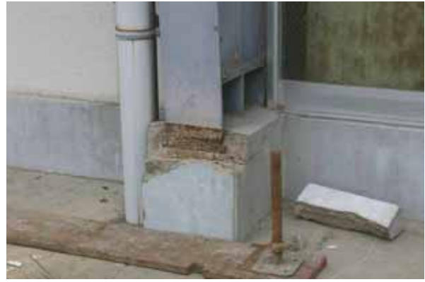
写真-4.8 コンクリートが剥落した鉄骨柱脚
