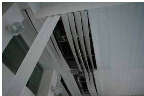
写真-4.30 落ちかけている天井パネル
