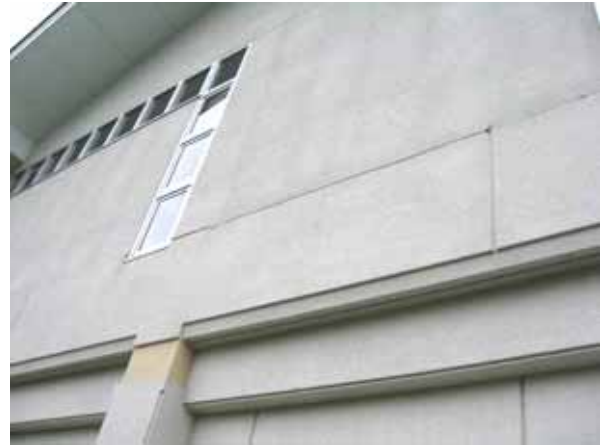
写真-4.14 脱落部と反対側妻面の ALC パネル
