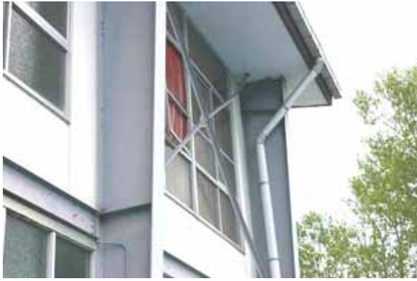
写真-4.7 座屈したブレースと破損した窓ガラス
