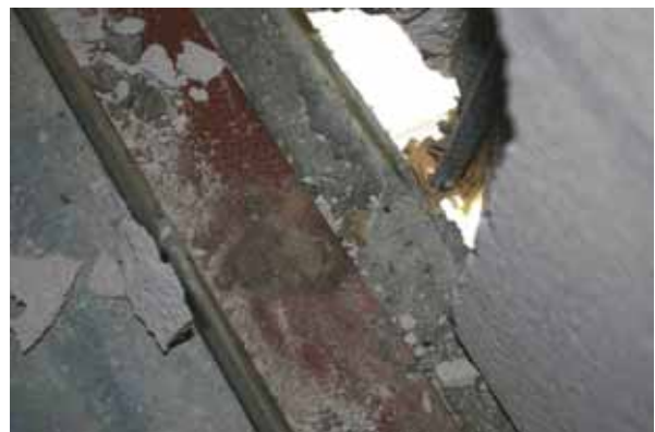
写真-4.12 溶接跡の見られるALCパネル下端部
