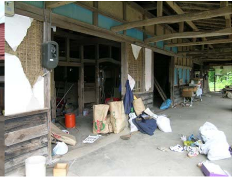
土壁の剥落(同・牛小屋部分)
