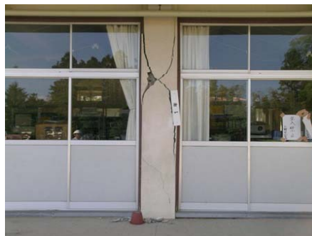
1F東側柱せん断ひび割れ (ほぼ全数)
