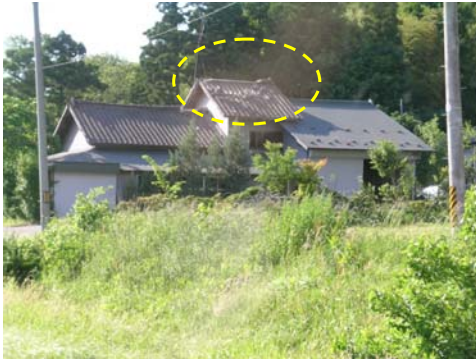
棟瓦脱落(大崎市上野目)
