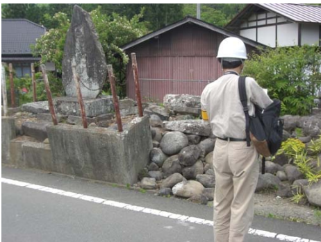
石積み・擁壁の崩落
