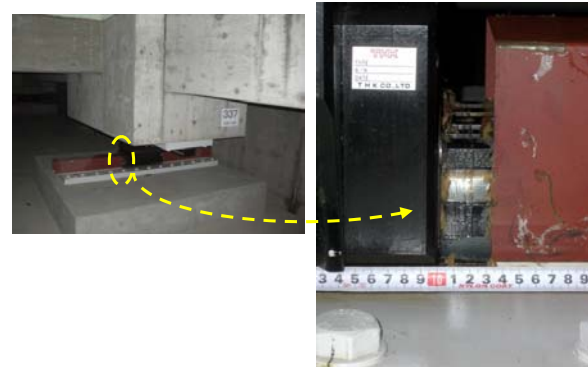
転がり支承カバーの残留変位(3cm程度)
