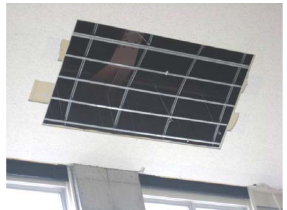
アリーナ天井板の被害(公共体育施設D)
