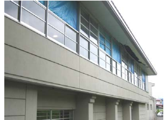
桁行方向の窓ガラス破損及び軒天落下(学校体育館C)
