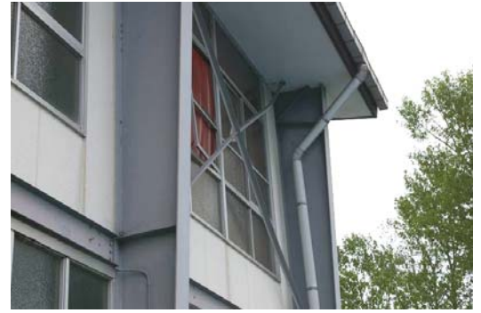
ブレース座屈箇所の窓ガラスの破損(学校体育館B)
