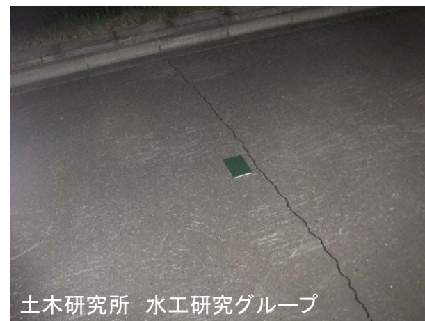
天端舗装の横クラック
