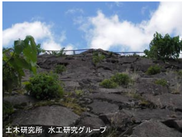
建設時(投石工法)のピアの天端の突出
