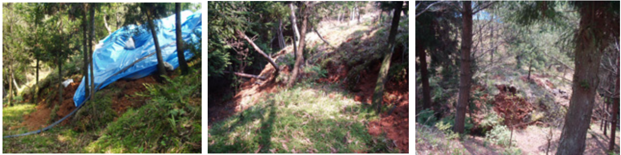
写真-24 崩壊した斜面の先端付近の状況
