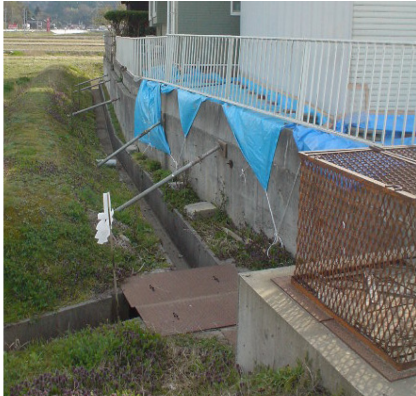
ブロック 2 段積み、擁壁の沈下と傾斜、高さ約 1.5m
