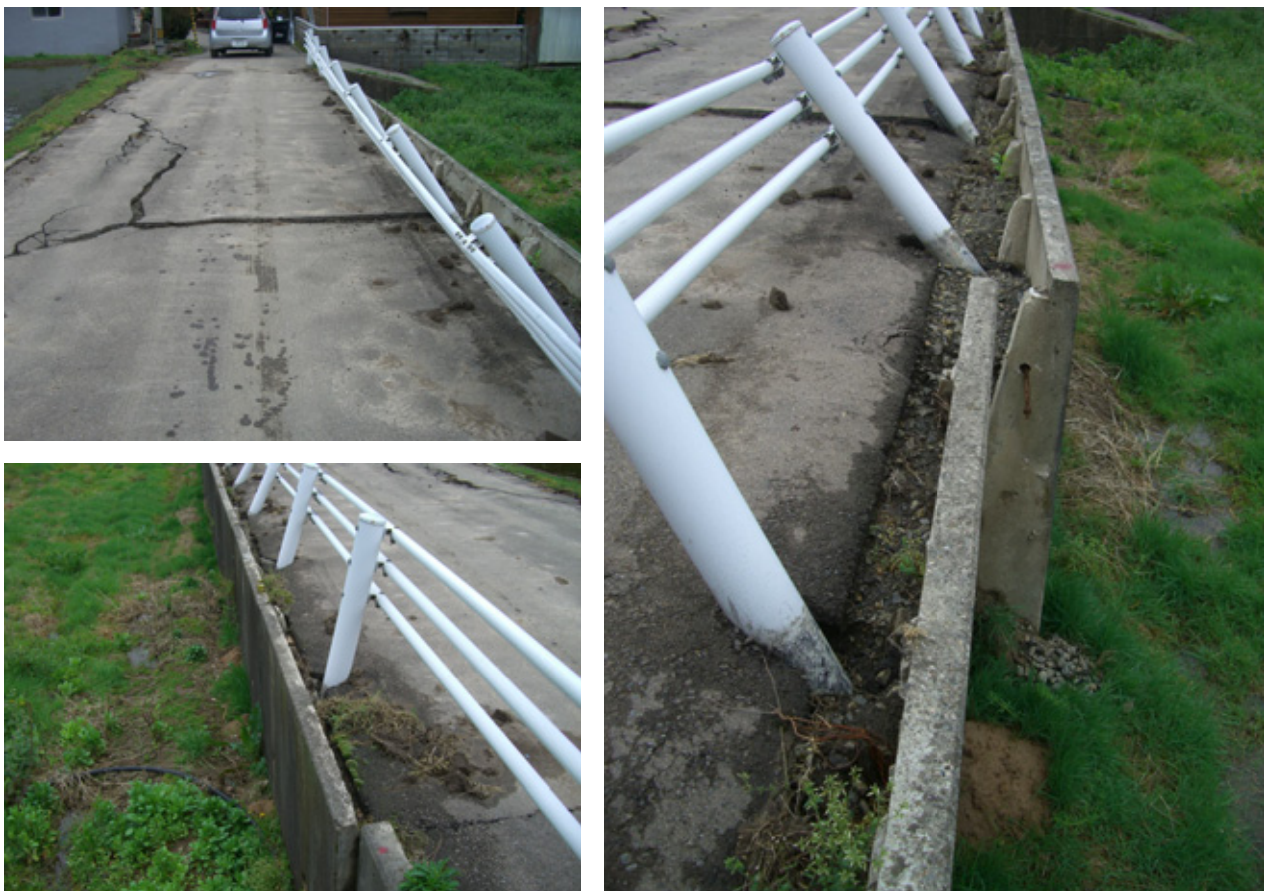
写真-12 L型コンクリート擁壁の被害例
