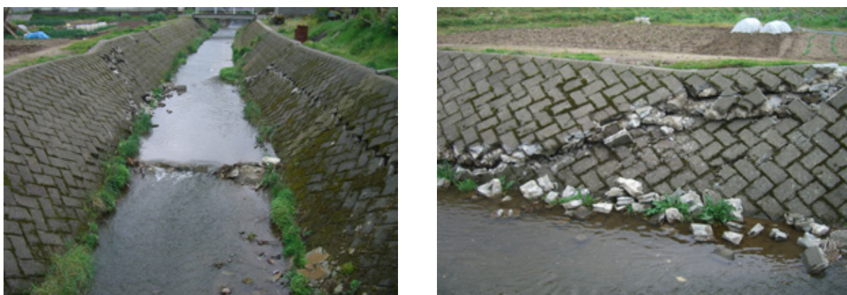
写真-13 ブロック積み擁壁の被害（門前道下地区） 局部的な隆起・沈降が認められ、断層の影響と考えられている
