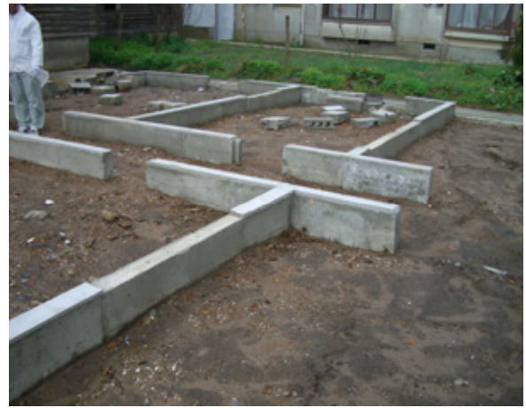
写真-9 アンカーボルトが乏しい基礎 無筋コンクリートの基礎
