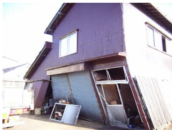
写真 5.2 倒壊寸前のチップ工場の倉庫
