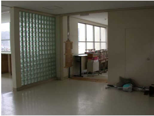
写真 6.9 校舎 EXP.J 部の被害
