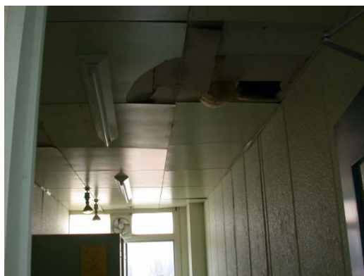
写真 7.5 天井パネル被害
