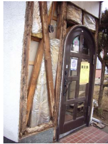
写真 5.46 木造躯体の腐朽
