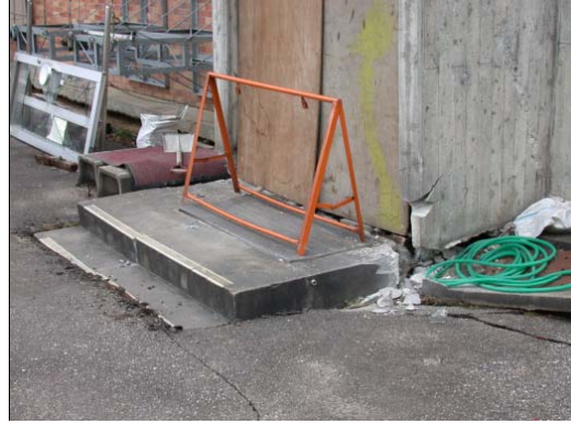
写真 6.15 建物周辺部の液状化被害
