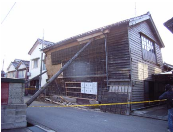
写真 5.5 倒壊寸前の土塗り壁を有する家屋
