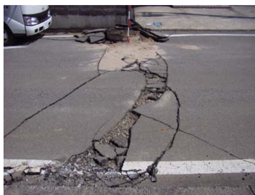
写真 6.6 総合福祉会館周辺の地盤変状
