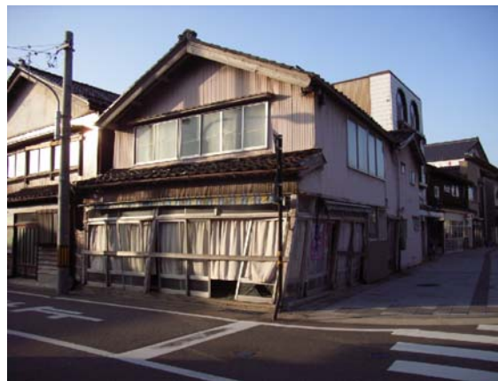
写真 5.6 大きく傾いた店舗併用住宅
