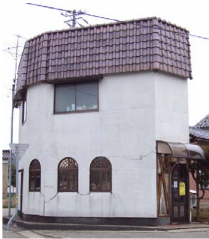
写真 5.45 躯体の腐朽が確認された店舗
