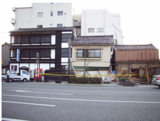
写真 7.3 大破したS造店舗（輪島地区、1階部が倒壊し、隣接建物に寄りかかった状態）
