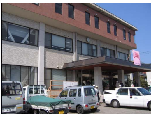
写真 6.3 門前町役場（RC 造 3 階建て） （建物無被害、周辺地盤の隆起・ひび割れ）
