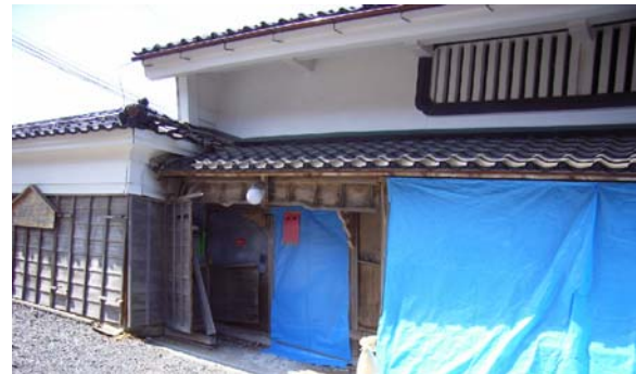
写真 5.32 残留変形が大きい住宅
