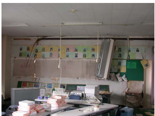
写真 7.8 妻壁被害（エアコン脱落）
