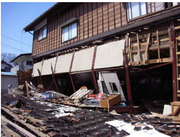
写真 5.15 倒壊は免れたが柱が折損した住宅
