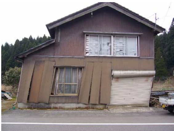
写真 5.47 残留変形が大きい車庫付き家屋
