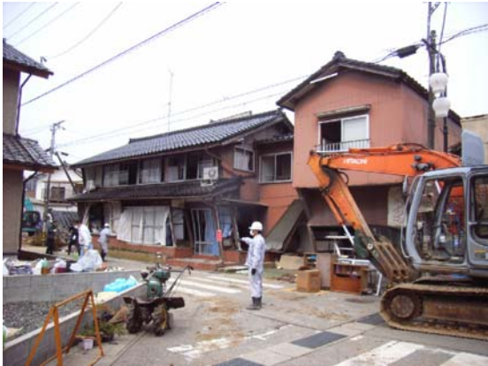
写真 5.41 残留変形が大きい店舗併用住宅
