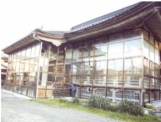
写真 5.9 カーテンウォールの被害
