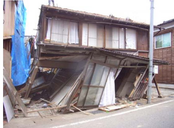
写真 5.42 倒壊寸前の建物
