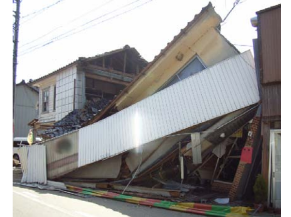
写真 5.22 倒壊した店舗併用住宅
