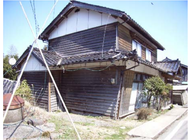
写真 5.14 道路側に大きく傾いた家屋
