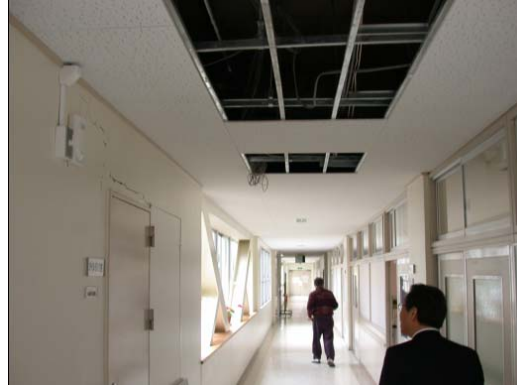
写真 6.10 校舎の廊下天井パネルの落下
