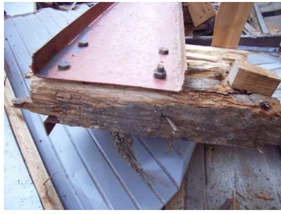
写真 5.4 左の家屋の鉄骨梁と木材柱の腐朽
