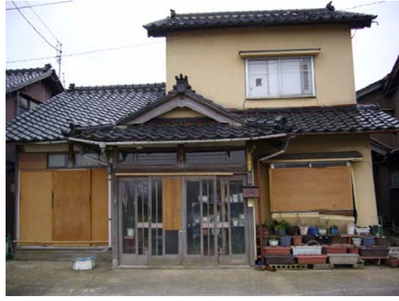
写真 5.50 国道 249 号線沿いの被害家屋
