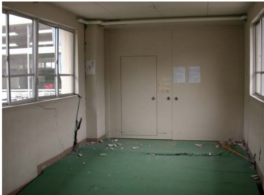
写真 6.11 校舎と講堂の渡り廊下の被害
