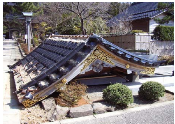
写真 5.18 倒壊した手洗い場の東屋
