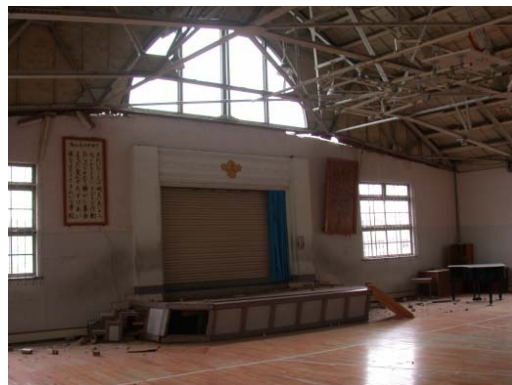
写真 6.12 講堂の妻壁部の被害
