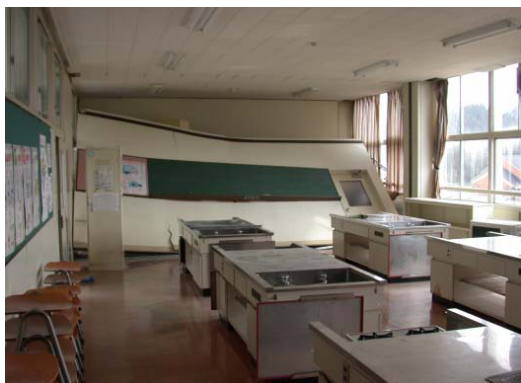
写真 7.6 間仕切り壁倒壊
