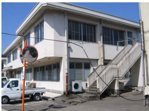
写真 6.5 門前地区の総合福祉会館 （柱、外壁に軽微なひび割れ、周辺地盤の変状）
