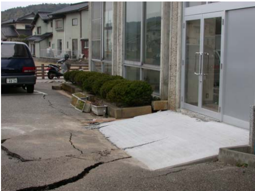
写真 6.16 建物周辺部の液状化被害
