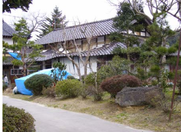
写真 5.52 奥原地区で大破した家屋
