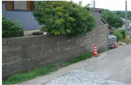
ブロック土留め壁体のねじれ
