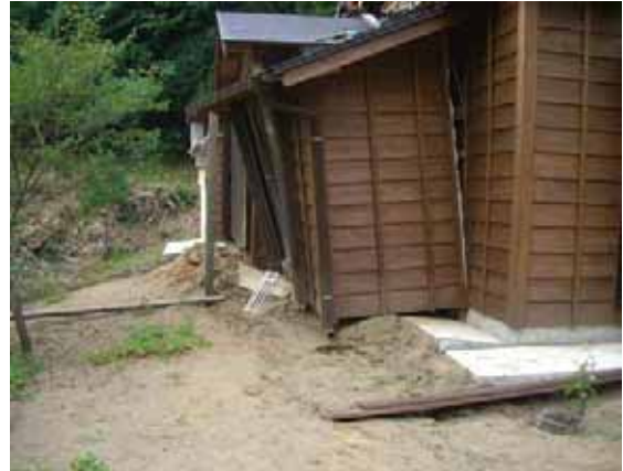
被災住宅 崖面側
