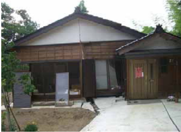
被災住宅 前面
