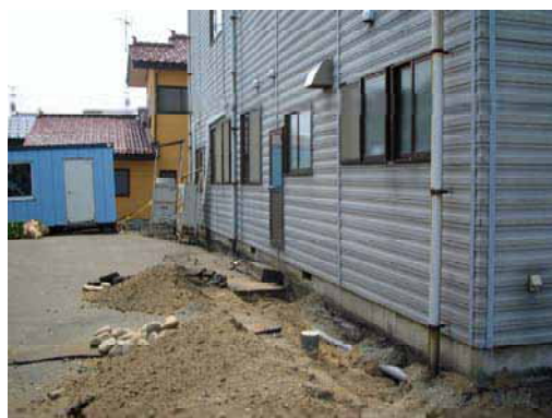
写真-8.2.2 鉄骨造 2 階の建物の不同沈下 （基礎形式：直接基礎、数十 cm の不同沈下）
