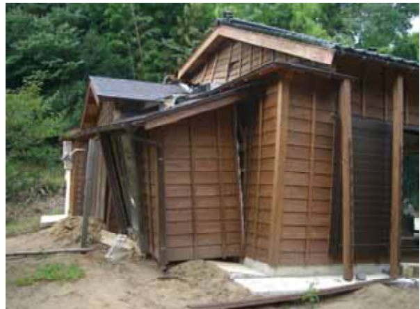
写真-6.2.2 刈羽村の液状化等に起因する地盤変動による新築住宅の被害
