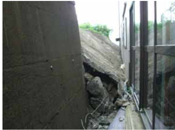
写真-7.1.4 モルタル吹き付け壁面の崩壊
