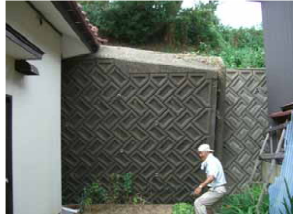
写真-6.3.2 ブロック積み擁壁の転倒例 地震直後にほぼ鉛直に起き上がり、数日後に転倒状態に達し、背面住宅にもたれかかった例
