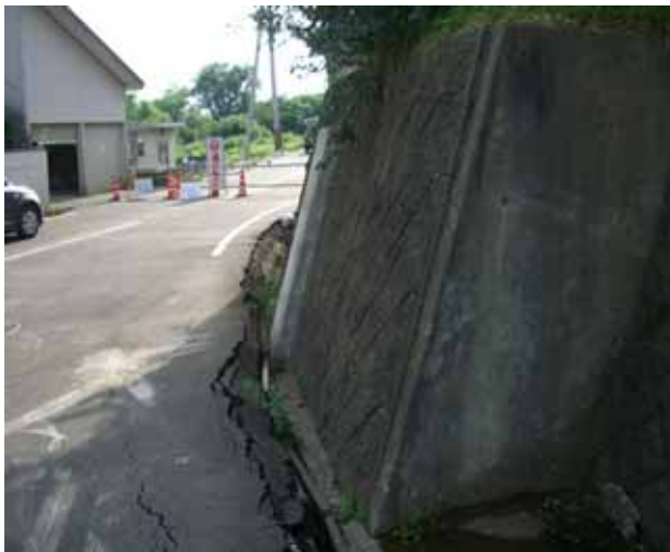
写真-6.3.3 間知ブロック擁壁の前面側 への滑り出し
