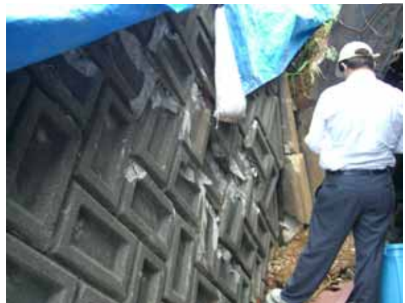
転倒部分に隣接する擁壁の壁体の破壊状況
