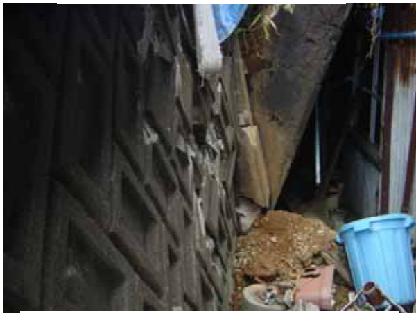
転倒した擁壁の下部 (底部が前面に約 20cm 押し出されている)
