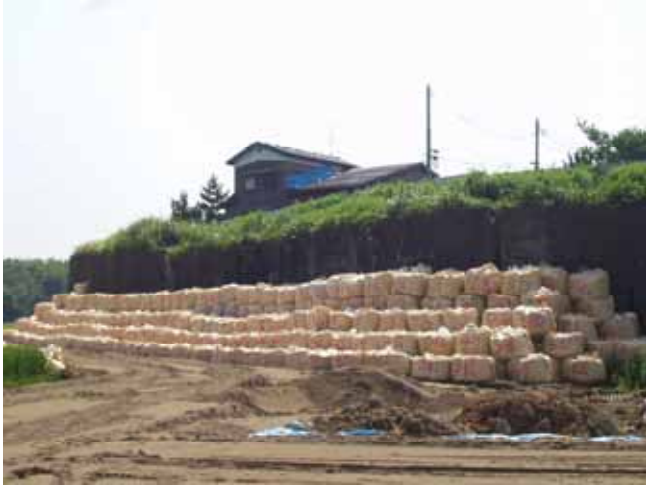
被災状況の全景（応急措置済）
