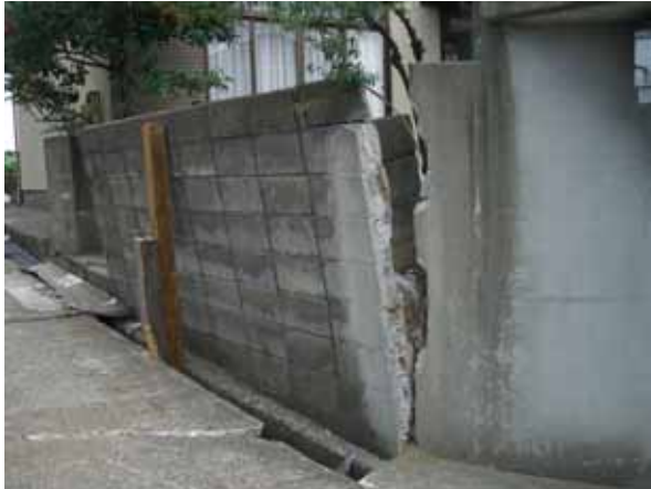
写真-6.3.1 ブロック塀による土留め擁壁の崩壊
