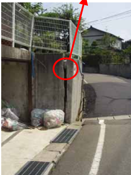
コンクリート擁壁のはらみ
