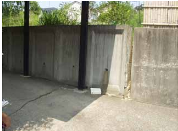
隣地擁壁との間に隙間
