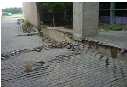
写真-8.2.1 建物周辺地盤の陥没 杭基礎建物（RC造） 建物周辺の地盤沈下は平均 30cm 程度 （最大 70cm 程度）
