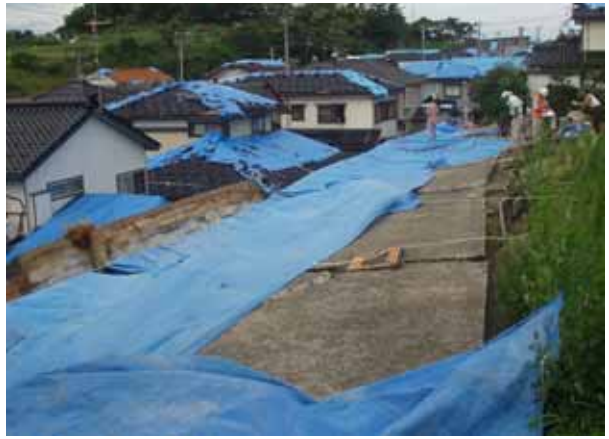
擁壁奥側（高さ 5m）よりの被害状況
