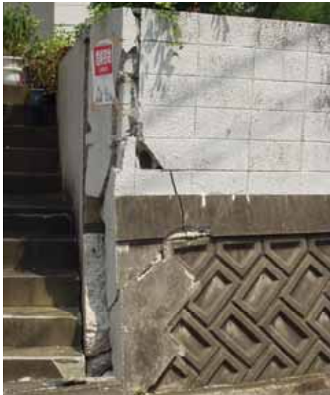
擁壁隅部の破壊
